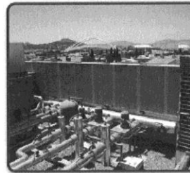
ΕΦΑΡΜΟΓΗ ΣΕ ΗΧΟΜΟΝΩΣΗ ΜΗΧΑΝΟΛΟΓΙΚΟΥ ΔΩΜΑΤΟΣ
